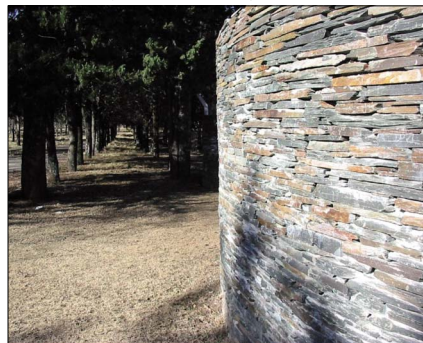
Müür. Ribakivi Rust, murtud pind
